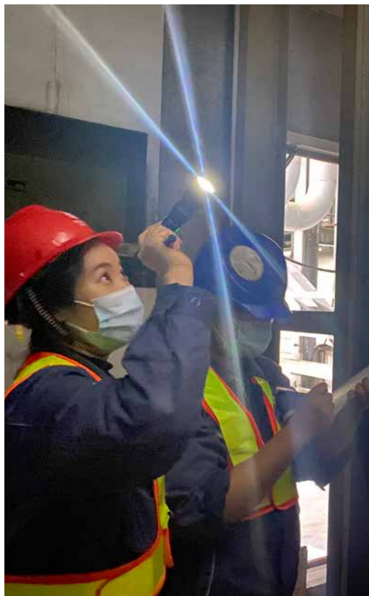
做好设备检修，保障电力可靠供应
