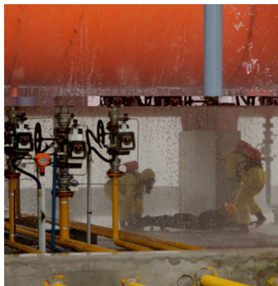
田集电厂开展氨站液氨泄漏应急演练
